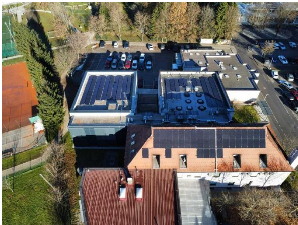
Slika: Sončne elektrarne
